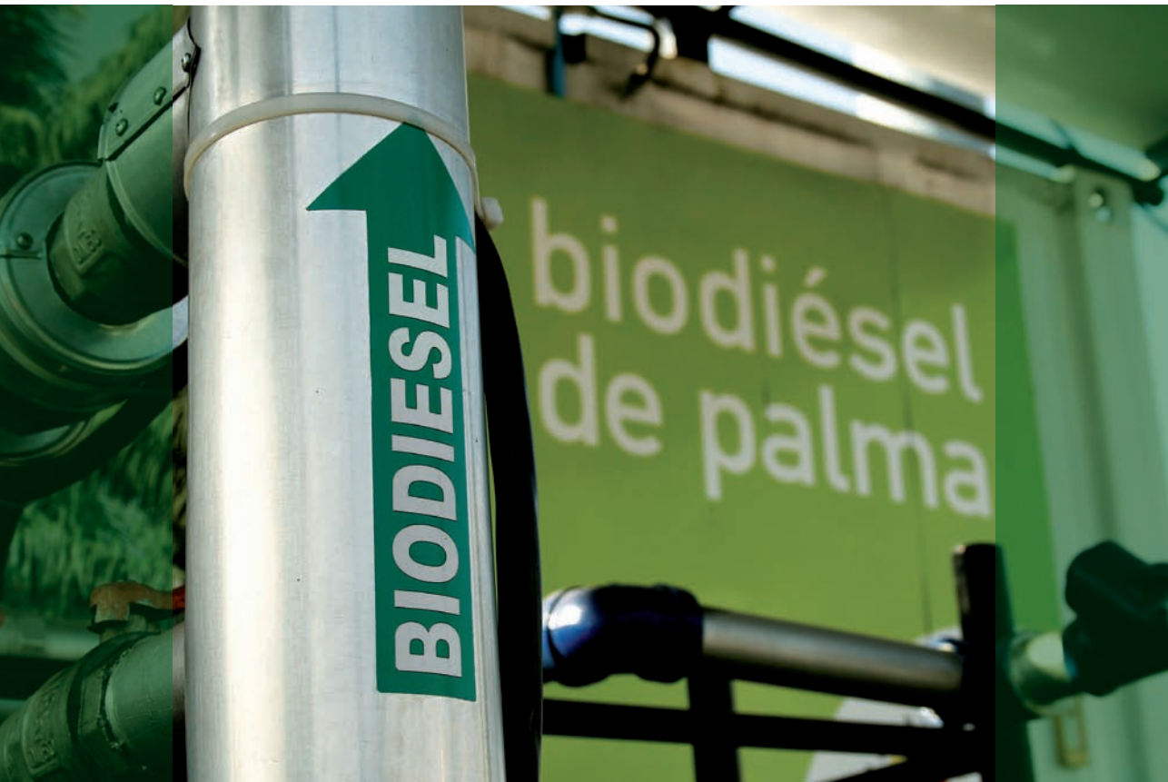
Estación de pruebas de biodiésel en Bogotá. Fotografía: Gutiérrez, R. y Olgún, J. L. (2008).
