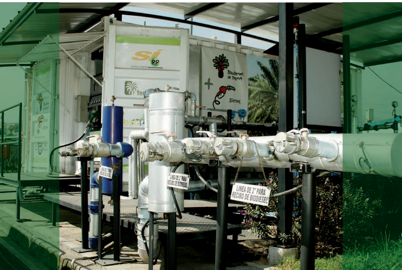
Líneas de recibo del biodiésel de palma en estación de mezcla. Fotografía: Gutiérrez, R. y Olguín, J. L. (2008).
