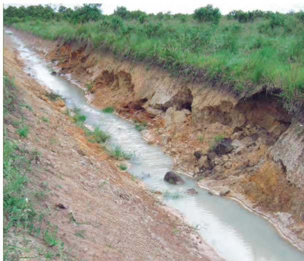
Figura 4. Canal de drenaje deformado por falta de talud en un sector arenoso del terreno de siembra.
