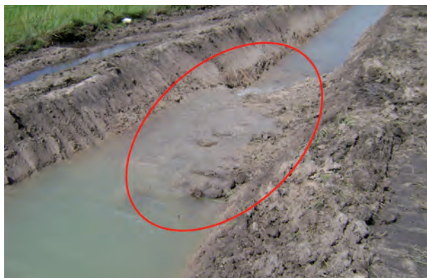
Figura 72. Trincho en canal principal de drenaje.
