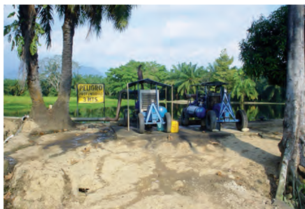
Figura 61. Motobomba diésel para distribución de agua de riego.
