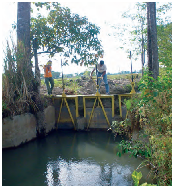
Figura 56. Bocatoma para captación de agua desde un río.
