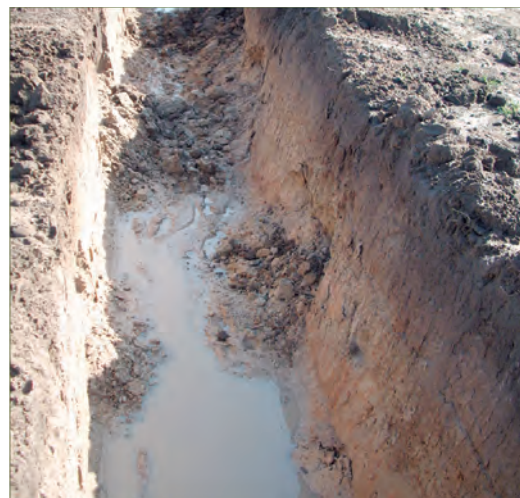
Figura 29. Canal sin diseño hidráulico.
