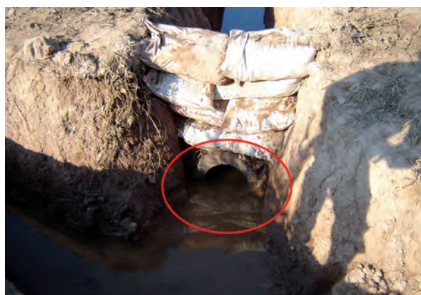
Figura 73. Trincho en canal de drenaje terciario.
