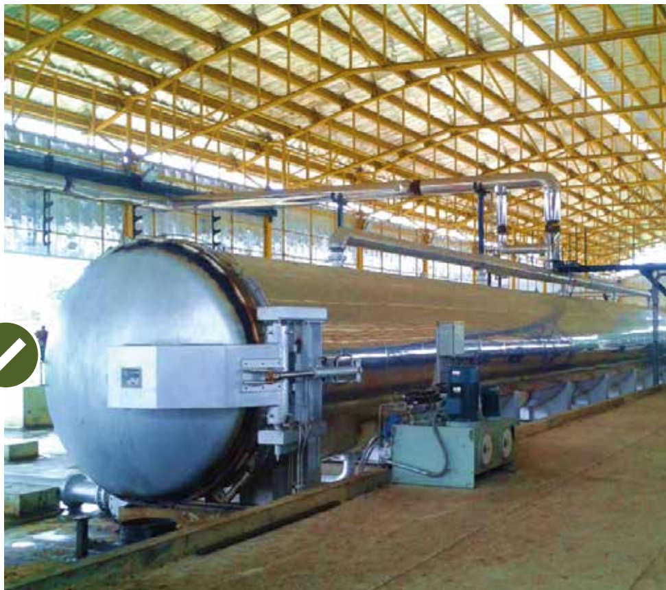
■ Conexión para desfogue/alivio de vapor por tubería de condensados de esterilización. Foto: Díaz, C.
