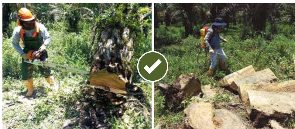
■ Eliminación de palmas enfermas y desinfección de residuos vegetales. Foto: Pérez, P.
