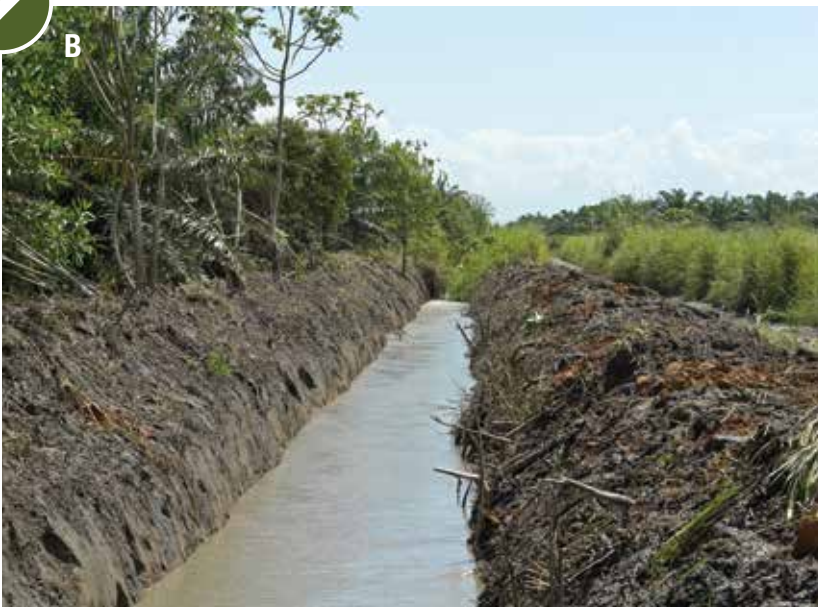
■ A. Rocería manual de drenajes. B. Drenaje en buen estado. Fotos: Ospitia, R. y Toro, F.
