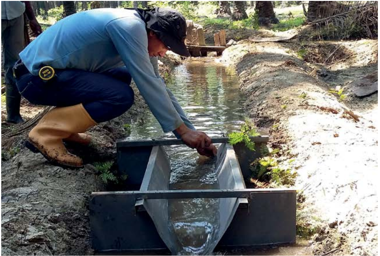
Aforador o canaleta RBC en el fondo del canal de drenaje para la medición del caudal.
